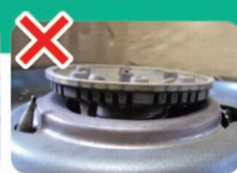
取付位置がずれた状態
